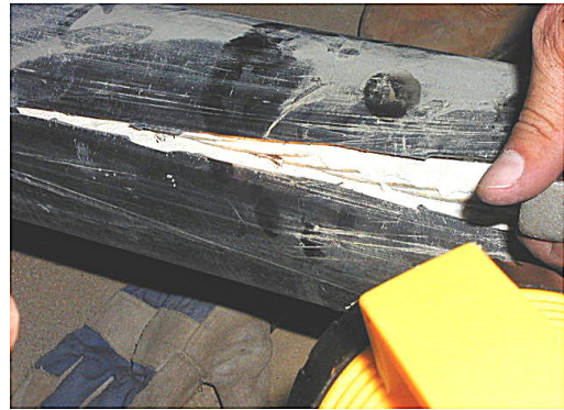
Fig. 4 Cracked PE Duct
