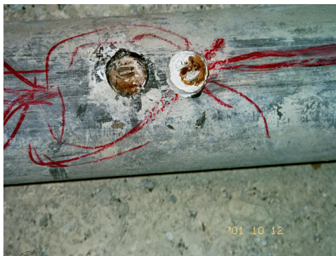
Fig. 6 Hole in PE Duct
