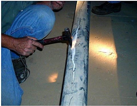
Fig. 3 Cracked PE Duct
